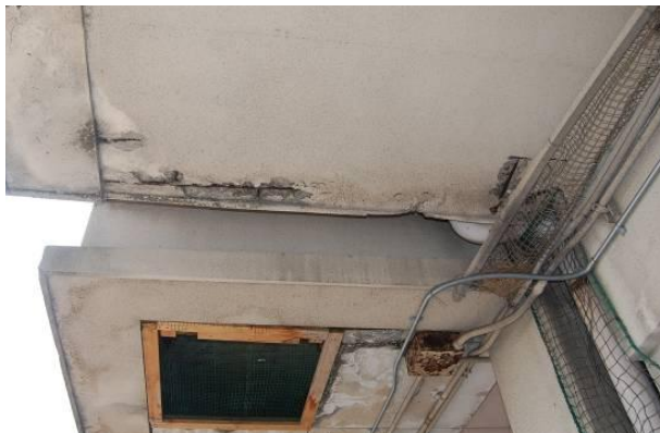
○高浜小学校（北校舎） 外廊下（バルコニー）の下端から躯体コンクリートと塗装の間に浸水し浮き・膨れが生じさらにコンクリートに浸水し爆裂している。
