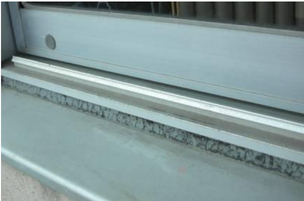
○港小学校（校舎） アルミサッシのシーリングが硬化しひび割れているため止水硬化が弱くなる。
