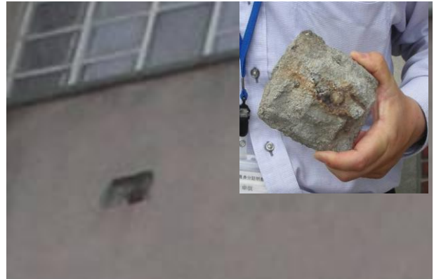
○港小学校（校舎） コンクリートに浸水した水と化学反応を起こし膨張しポップアウトしている。これだけ大きいのは珍しい。穴埋めした様な痕が他にもあることから注意が必要。
