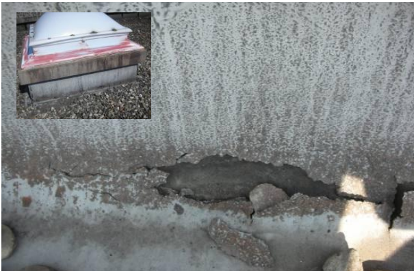
○図書館・郷土資料館 トプライトの立上り部分の防水層が破けている。直下階では雨漏りしている。
