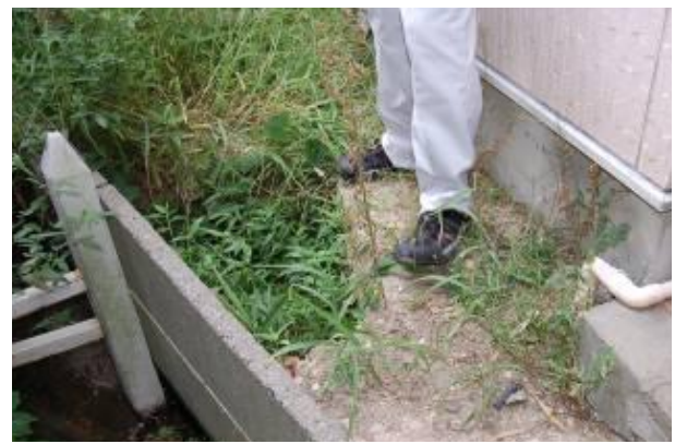
○宅老所「悠遊たかとり」 建物の北東側の地盤が陥没している。基礎下の土が流出していないか確認が必要。
