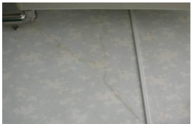
○吉浜北部保育園 外壁躯体のひび割れから浸水し、屋内の壁クロスに染み出している。
