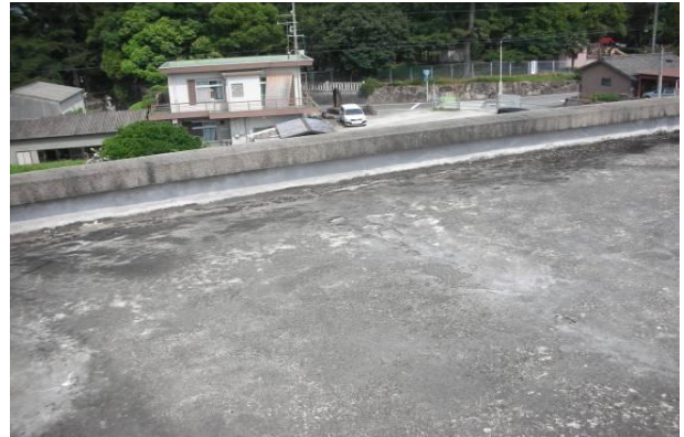
○吉浜北部保育園 全体的に磨耗しており随所で防水層が破けている。直下階の天井に雨漏り痕が多数見られる。
