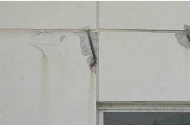
○高浜中学校（北校舎） ひび割れから浸水し鉄筋が錆により膨張しコンクリートが爆裂しているのが随所で見られる。
