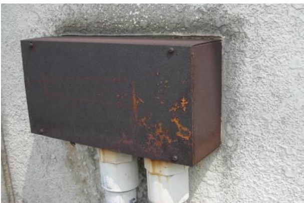
○東海会館 海が近い為、塩害による外部のスチールは錆びている。このまま放置すると腐食する。
