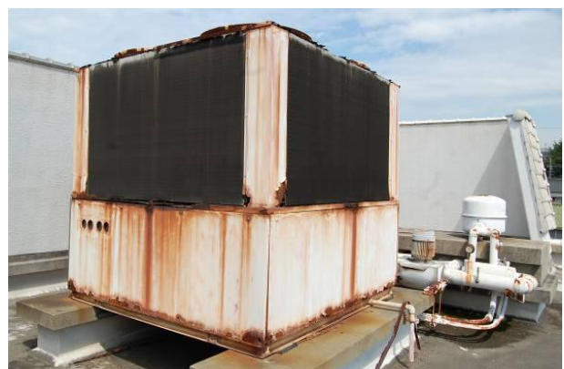
○高浜南部保育園 屋上に設置してある空調機や配管等が錆びて腐食しはじめている。空調機は建設時に設置したもので耐用年数を大きく超えており異音も出始めている。
