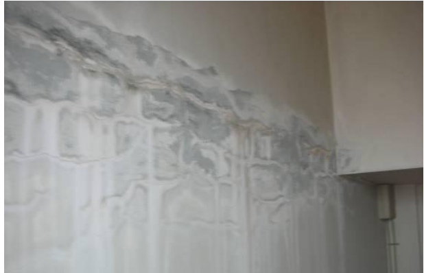
○港小学校（校舎） 外壁躯体のひび割れから浸水し、屋内の壁に染み出し塗装が劣化している。
