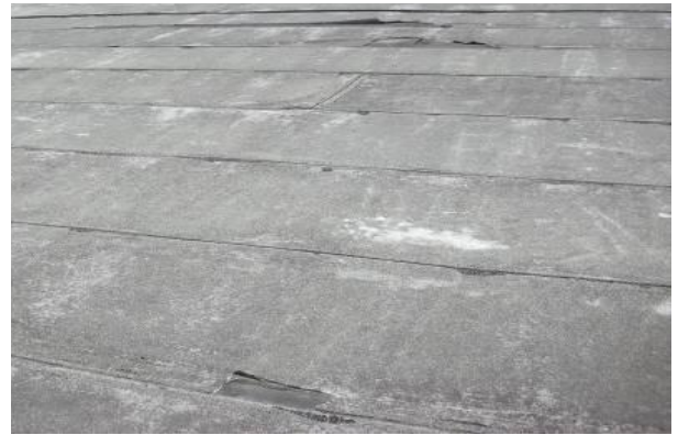
○中央公民館（市民ホール） 防水層のトップコートが磨耗により剥げており、シート自体の剥れも随所に見られる。
