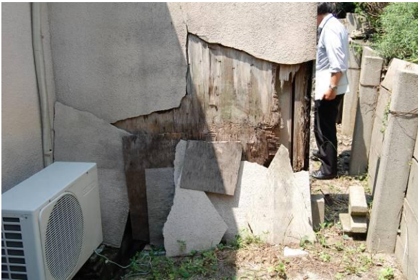
○高浜中部老人憩いの家 内部建具を収納するためのスペースが外部に突き出ているが漏水により木の柱及び壁下地が腐食し損壊している。
