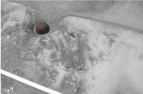
○高浜小学校（南校舎） ルーフトレイン廻りの防水層に浮きが見られ破けている。
