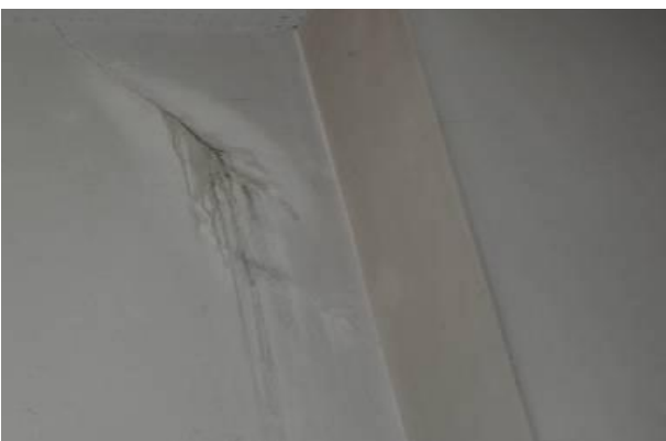
○吉浜北部保育園 外壁躯体のひび割れから浸水し、屋内の壁に染み出し塗装が劣化している。
