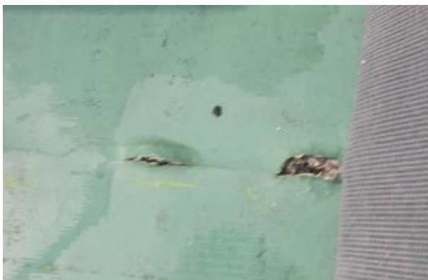
○吉浜北部保育園 全体的に老朽化は認められないが部分的に防水層の破けが見られる。直下階の天井に雨漏り痕が見られる。
