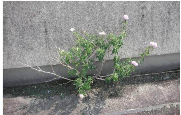
○港小学校（校舎） 屋上排水溝に土砂が堆積し木が生えている。根が防水層を破っている場合もあるので無理に抜かず伐採したほうがよい。
