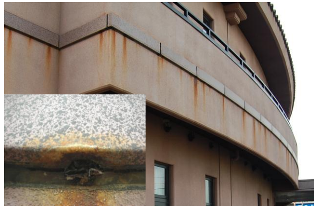
○高取公民館 外壁のボーダーの飾りに浸水し、錆汁が垂れて外壁を汚している。
